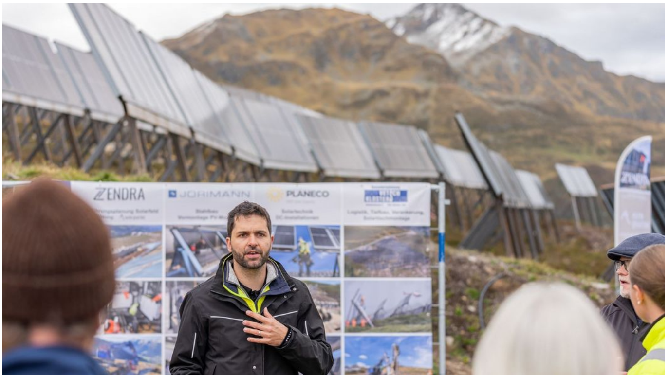
Electricità invernale: prima della sospensione dei lavori dovuta alle condizioni meteorologiche, il 20 per cento dell'impianto era già stato collegato alla rete.
