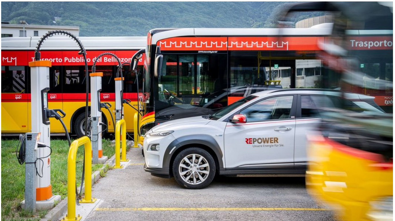
Repower rüstete für PostAuto Schweiz das Depot Bellinzona mit modernster DC-Ladeinfrastruktur aus.
