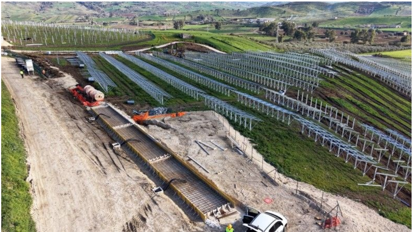
Der Agrar-Photovoltaikpark Ciminna bei Palermo wird im Endausbau jährlich über 120 GWh Strom produzieren.
