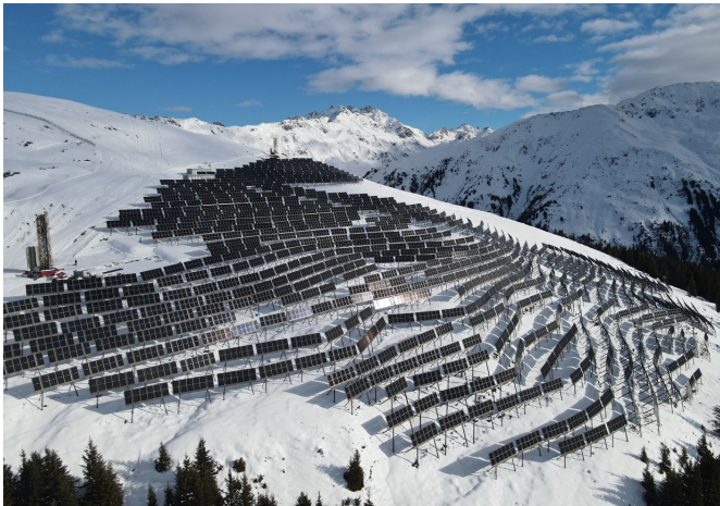
Winterstrom: Vor dem witterungsbedingten Baustopp gingen bereits 20 Prozent der Anlage ans Netz.
