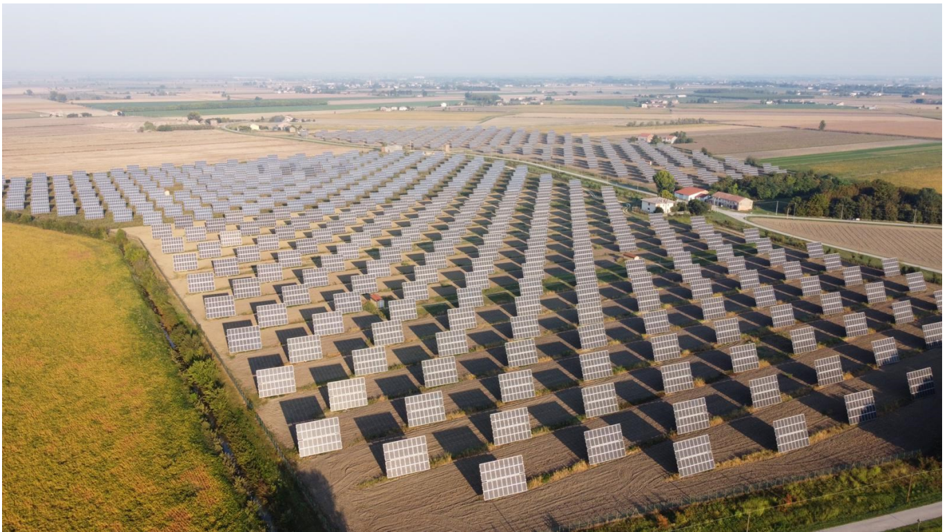
Die Photovoltaikanlage in Castelguglielmo wurde mit effizienteren bifazialen Modulen ausgerüstet.
